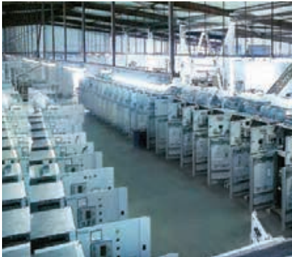
Ячейки высоковольтные для ЦОД ФНС РФ
